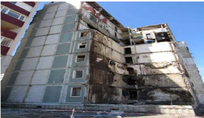
Рис. 3. Загальний вид на руйнування частини блок-секції великопанельного багатоквартирного житлового будинку на вул. захисників України, 25 в м. Умань
