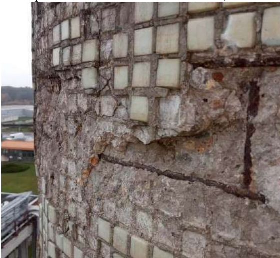
Рис. 3. Руйнування поверхні бетону та оголення і корозія арматури
