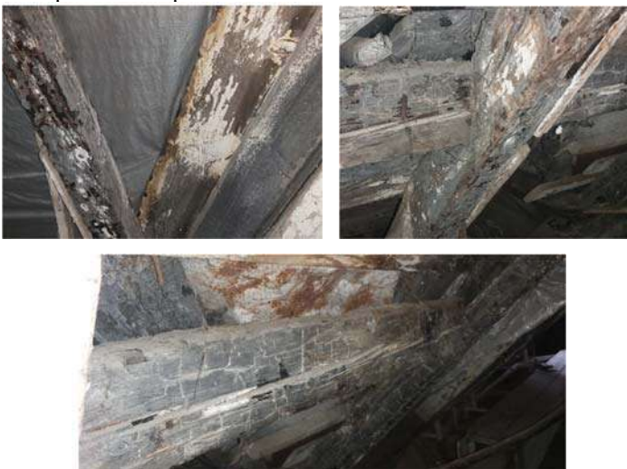
Рис. 4 Пошкоджені елементи даху пожежею
