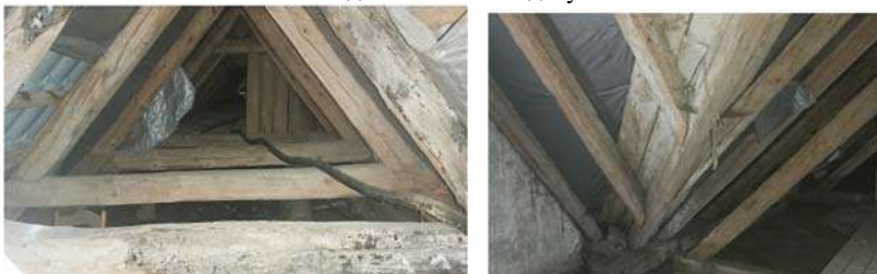
Рис. 5. Загальний стан конструкцій даху
