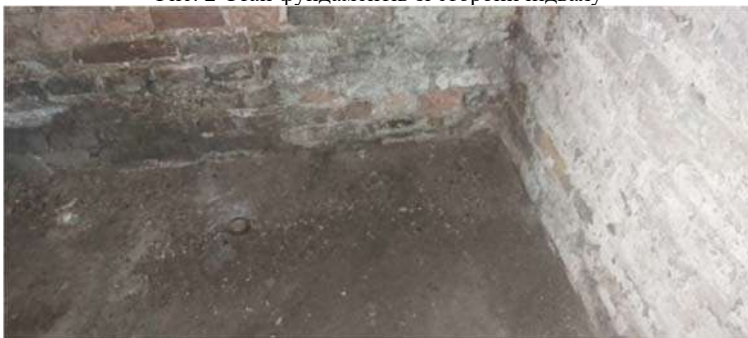
Рис. 2 Стан фундаментів зі сторони підвалу
