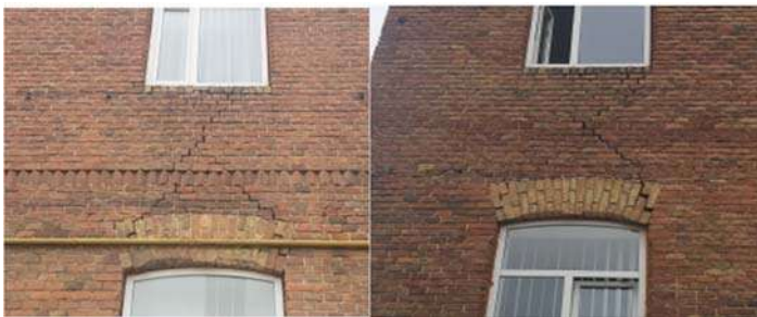
Рис. 3 Тріщини на фасаді будівлі
