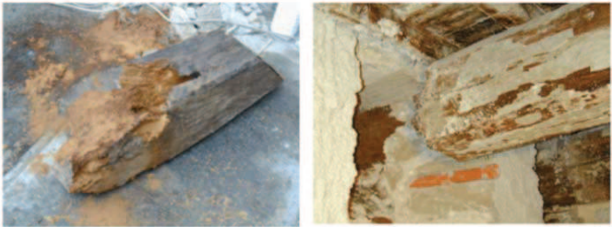
Рис. 1. Пошкодженні торцеві елементи балок історичних будівель [10].
