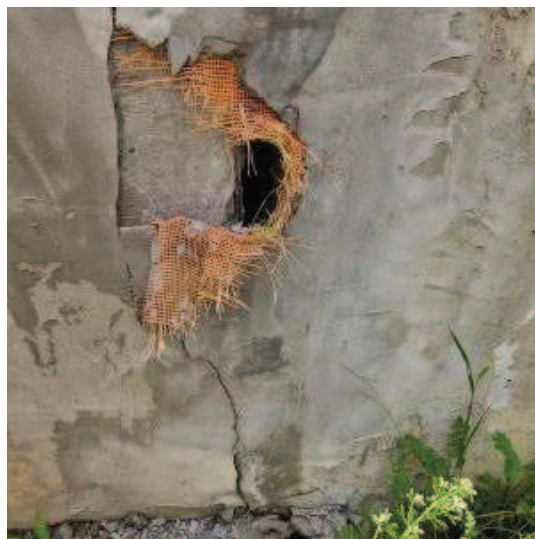
Рис. 3. Наскрізна вертикальна тріщина у стінці ПС-1 шириною розкриття 100 мм
