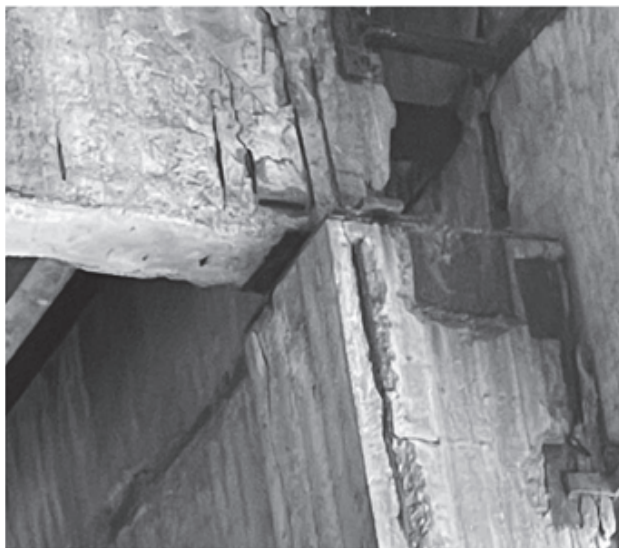
Рис.1. Відшарування захисного шару та оголення поздовжніх арматурних стрижнів колон
