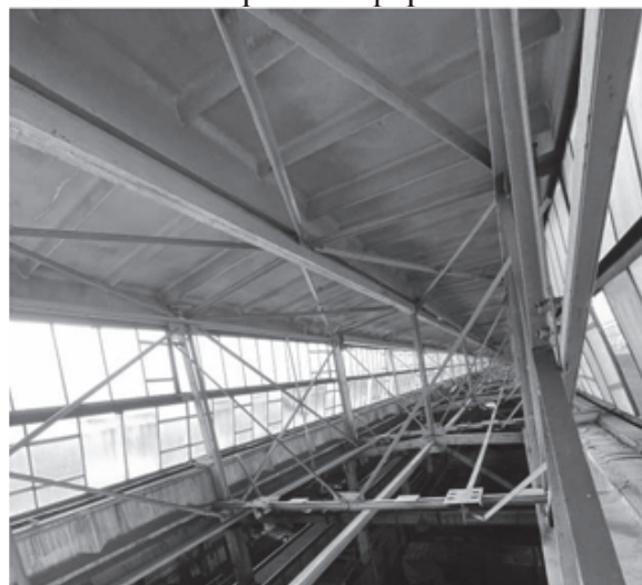
Рис.4. Локальне руйнування антикорозійного покриття та поверхнева рівномірна корозія
