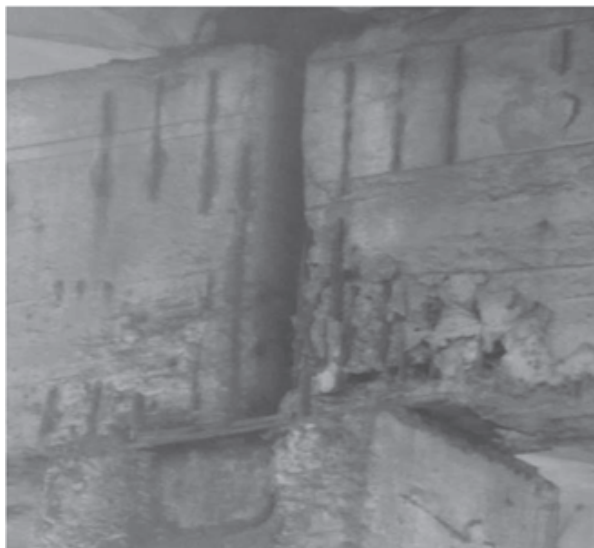
Рис.2. Відшарування захисного шару та оголення поперечних арматурних стрижнів ферм
