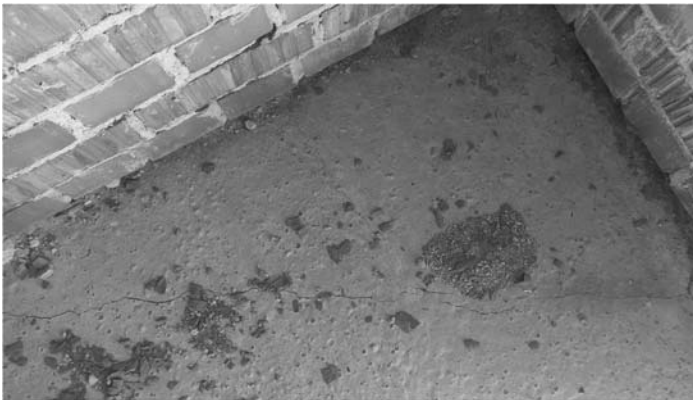
Рис. 2. Тріщини в плиті перекриття
