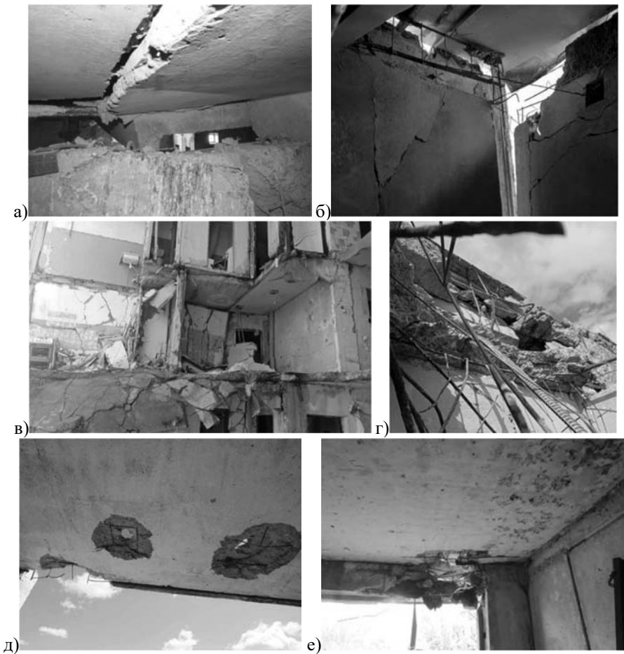
Рис. 2. Дефекти та пошкодження збірних залізобетонних перекриттів: а-б) розходження панелей та утворення тріщин у стиках панелей; в-г) обвал плит перекриття з оголенням робочого армування; д-е) утворення локальних наскрізних отворів в плитах
