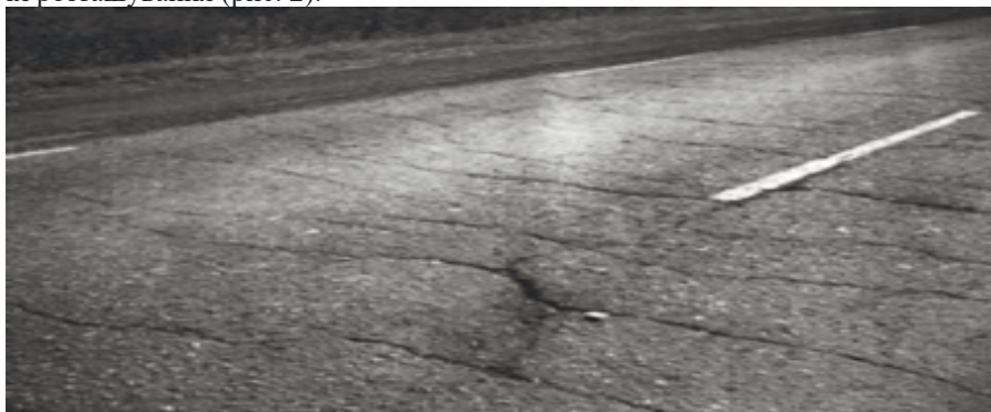
Рис. 2. Існуючі деформації та дефекти на ділянці автомобільної дороги Н-25 на ділянці км 175+950
